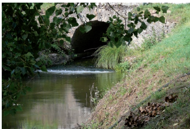
En 1934 un captage, connecté au Couesnon, a été mis en place près de Fougères.
